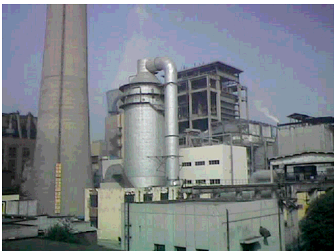
成都(中国)1997～ ガス流量: 300,000 m 3 /hr
